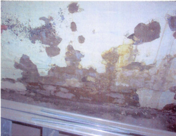
Billede 7: Fugt i kælderydervæg.
