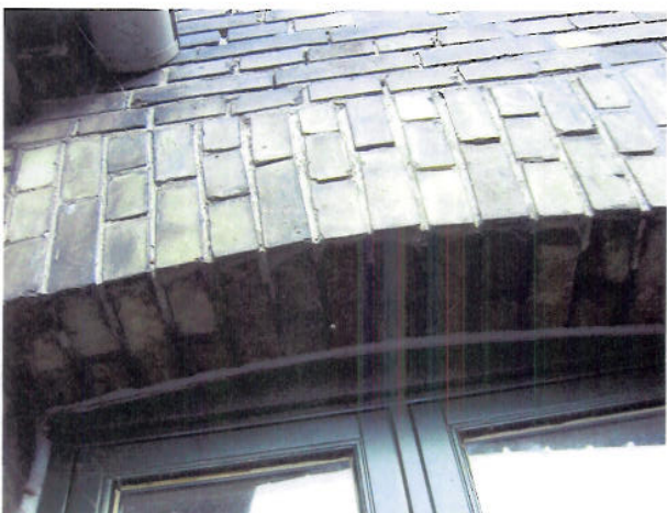
Billede 15: Udvaskede fuger gårdfacde.
