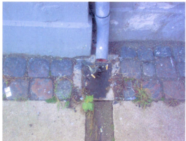
Billede 10: Utæt vandrende.
