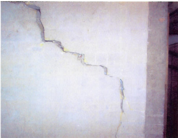
Billede 9: Sætningsrevne i kælder.
