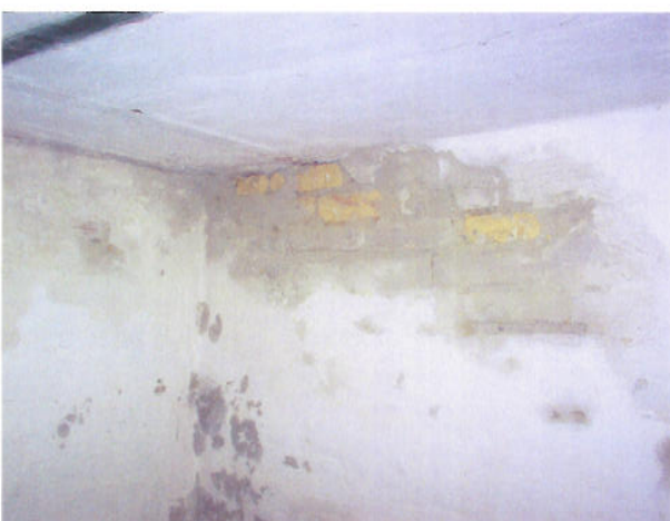
Billede 11: Fugt ved bagtrappe.
