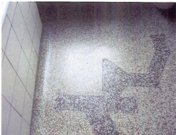
Billede 13: Revne i badeværelsesgulv.
