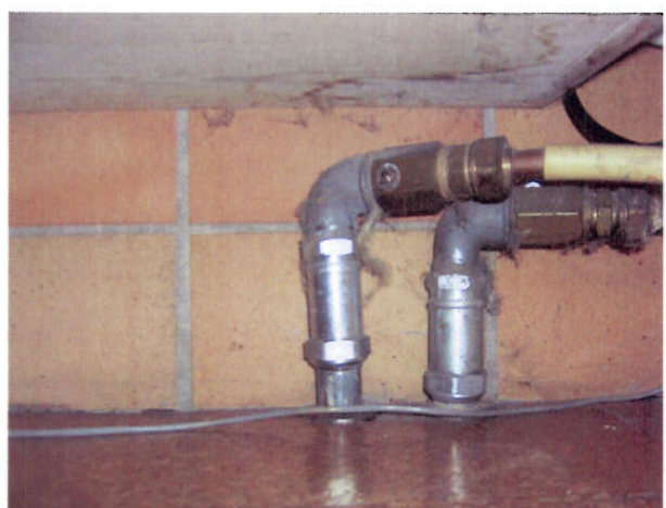
Billede 12: Direkte overgang Galvaniseret rør til kob
