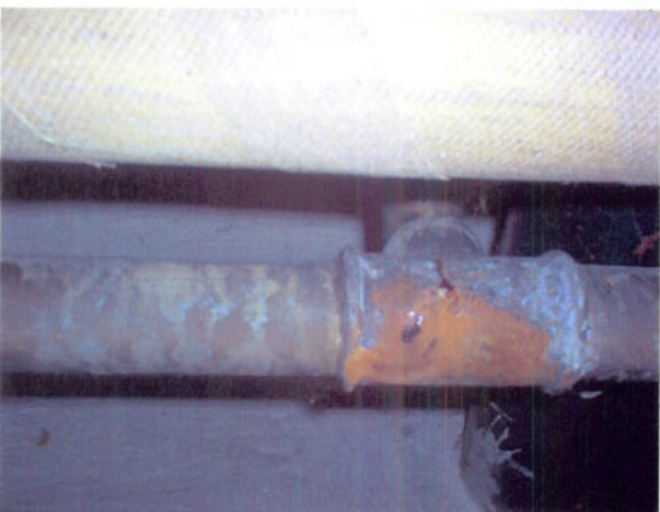
Billede 5: Tæret fitting på vandrør i kælder.
