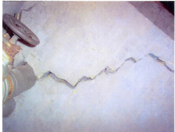
Billede 8: Sætningsrevne i kælder.
