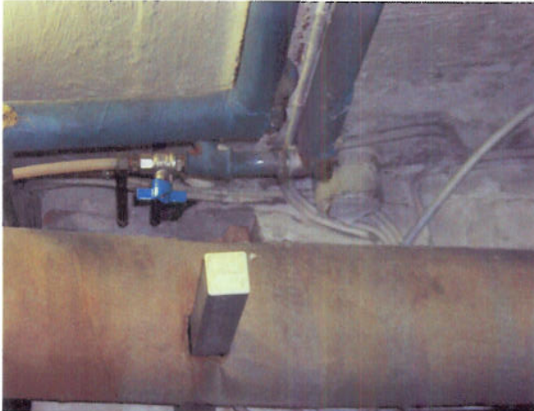
Billede 1: Tæret galv. fitting og overgang til kobber
