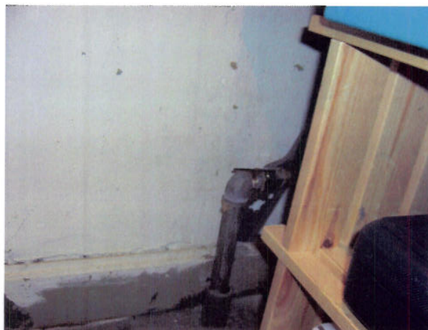
Billede 14: Tæret fitting og overgang galvaniseret til
