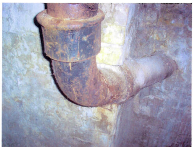
Billede 4: Tæret faldstamme i kælder.
